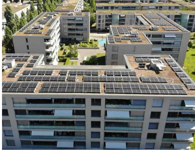
Photovoltaik-Anlage am Pappelweg in Rheinfelden
