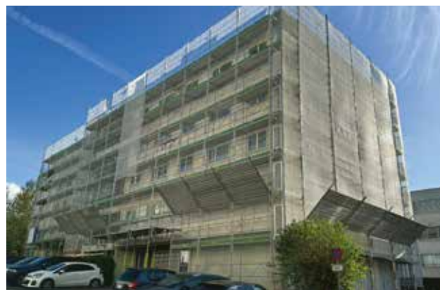
Komplette Renovierung der bestehenden Gebäude an der Rue du Caudray 32, 34, 36 in Renens.
